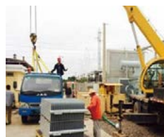
中葡基金参与投资的安哥拉运输电器材生产项目
